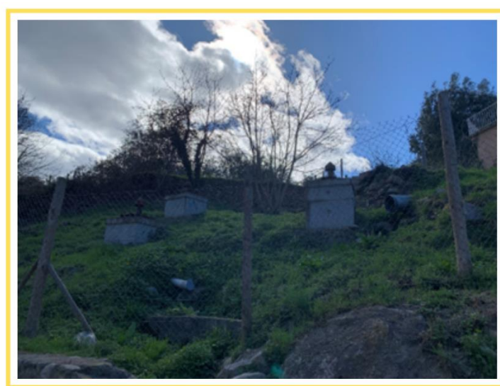
Figure 60 - Photographie des pompes de la zone de pompage d'Espira-de-Conflent, auteure 2023.
