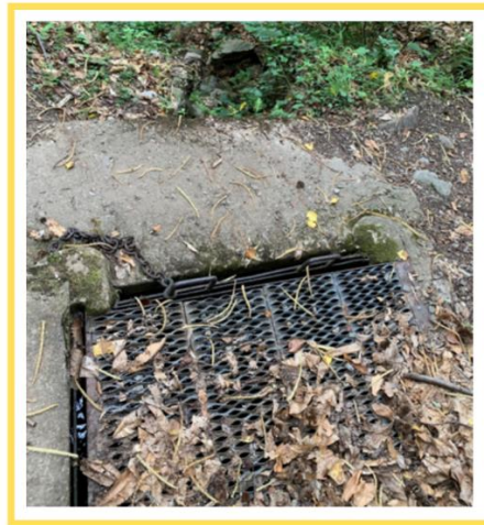
Figure 38 - Photographie de l'une des grilles du système d'irrigation gravitaire de la vallée du Llech, auteure 2023
