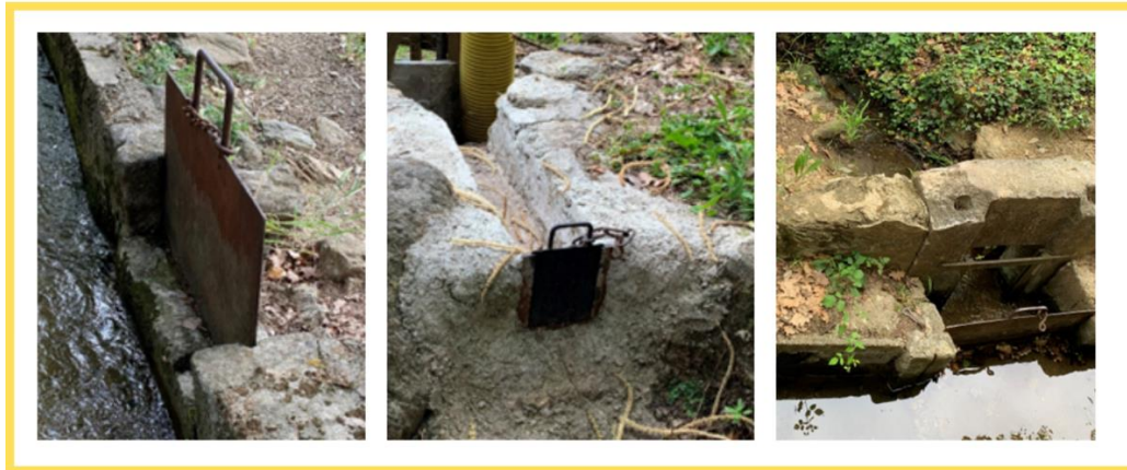
Figure 36 - Photographies de vannes du système d'irrigation gravitaire de la vallée du Llech, auteure 2023.
